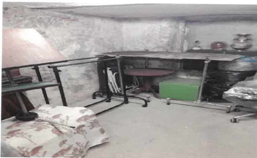
Odparzone tynki na ścianach
