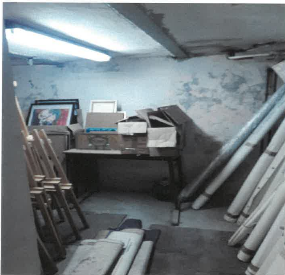
Odparzone tynki na ścianach
