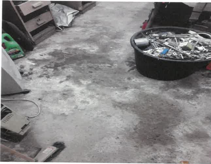
Widoczne zwilgocenie posadzki pom.warsztatowego.
